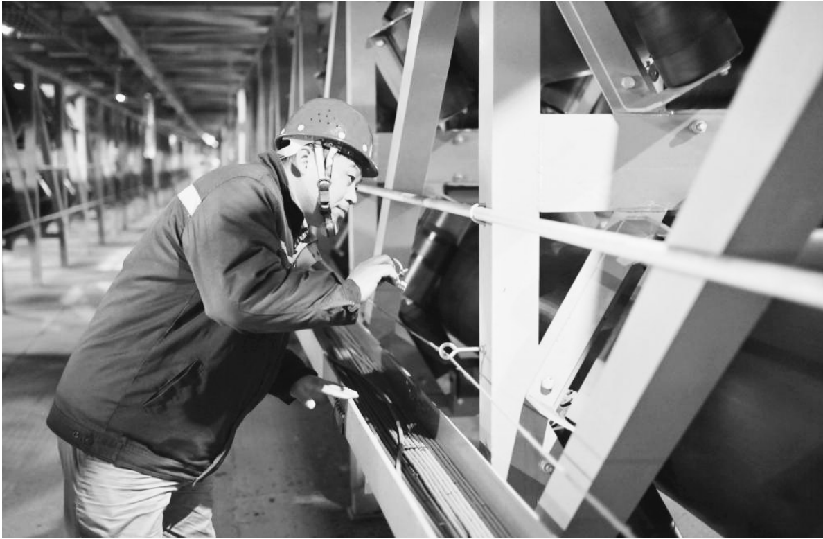
河北省唐山市海港经济开发区管带机廊道项目近日竣工投入试运行。据介绍,该项目通过3条管状带式输送机为临港企业从码头堆场运输矿石、煤炭等大宗物料,年输送能力达3900万吨,可有效缓解汽车运输造成的交通阻塞,减轻空气污染,促进区域经济绿色发展。图为工人在唐山海港经济开发区管带机廊道查看运行状态。
