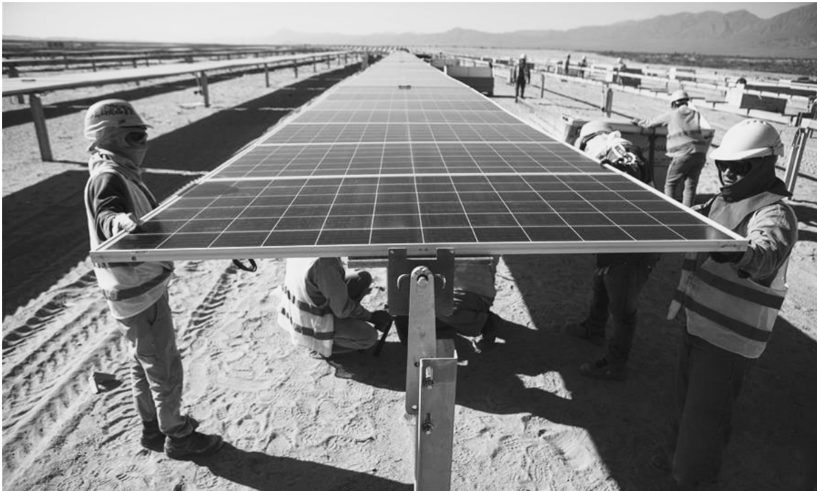
位于阿根廷西北部的卡法亚特处于荒漠地带,由于缺少水源发电,卡法亚特所在的萨尔塔省长期能源短缺。日前,中国电建集团贵州工程有限公司承建的卡法亚特100兆瓦光伏发电项目成功并网发电,投入商业运行,预计每年为阿根廷电网注入大约2.4亿千瓦时的清洁能源。
