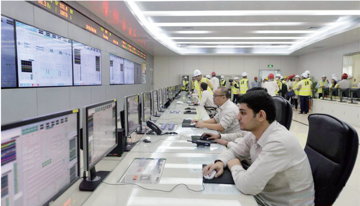
萨希瓦尔燃煤电站是中巴经济走廊优先实施项目,2017年7月全面建成投产。2018年,萨希瓦尔燃煤电站共发电90.4亿度,解决了上千万巴基斯坦人民的用电需求。图为在巴基斯坦东部旁遮普省萨希瓦尔,员工在萨希瓦尔燃煤电站控制室里工作。
