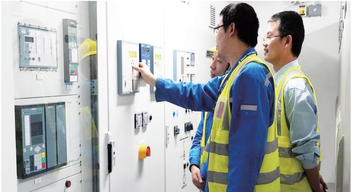
在距离约旦首都安曼约 35 公里处的扎尔卡市坐落着中国山东电力建设第三工程公司承建的约旦萨姆拉四期扩建联合循环机组项目。日前 ,项目圆满完成 168 小时满负荷试运行 ,这标志着该项目已具备投产条件 ,即将正式运行。
